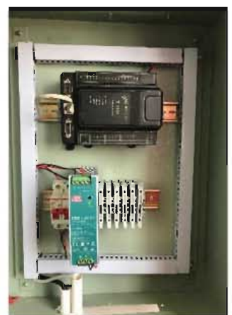
图7 数据采集系统(RTU)
